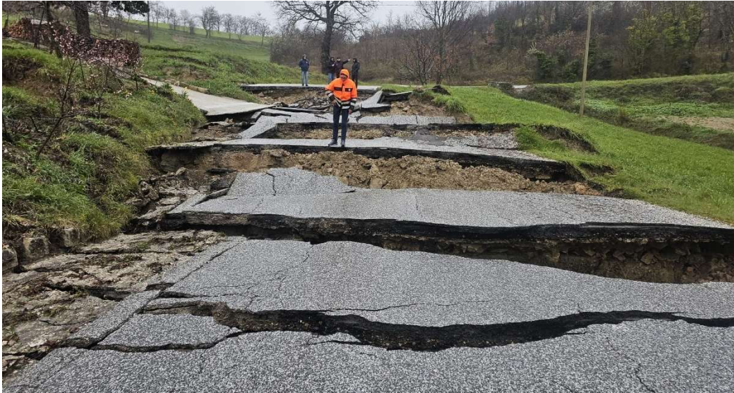
Figura 59 - Dissesto idrogeologico in agro di Agnone. @Foto Comune Agnone.
