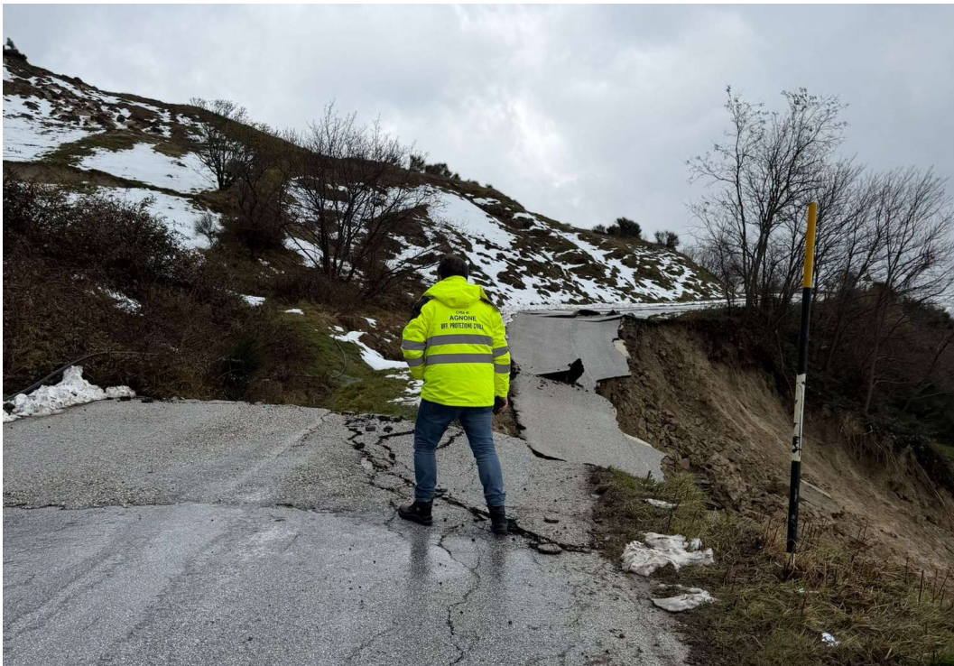
Figura 58 - Dissesto idrogeologico in agro di Agnone. @Foto Comune Agnone.
