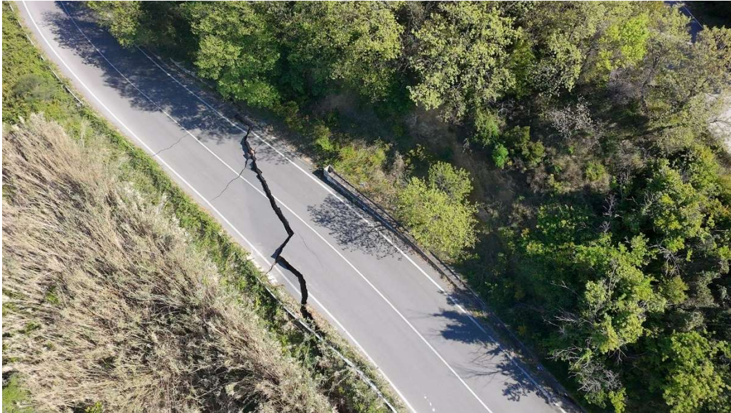
Figura 13 - Frana di Petacciato - viabilità provinciale
