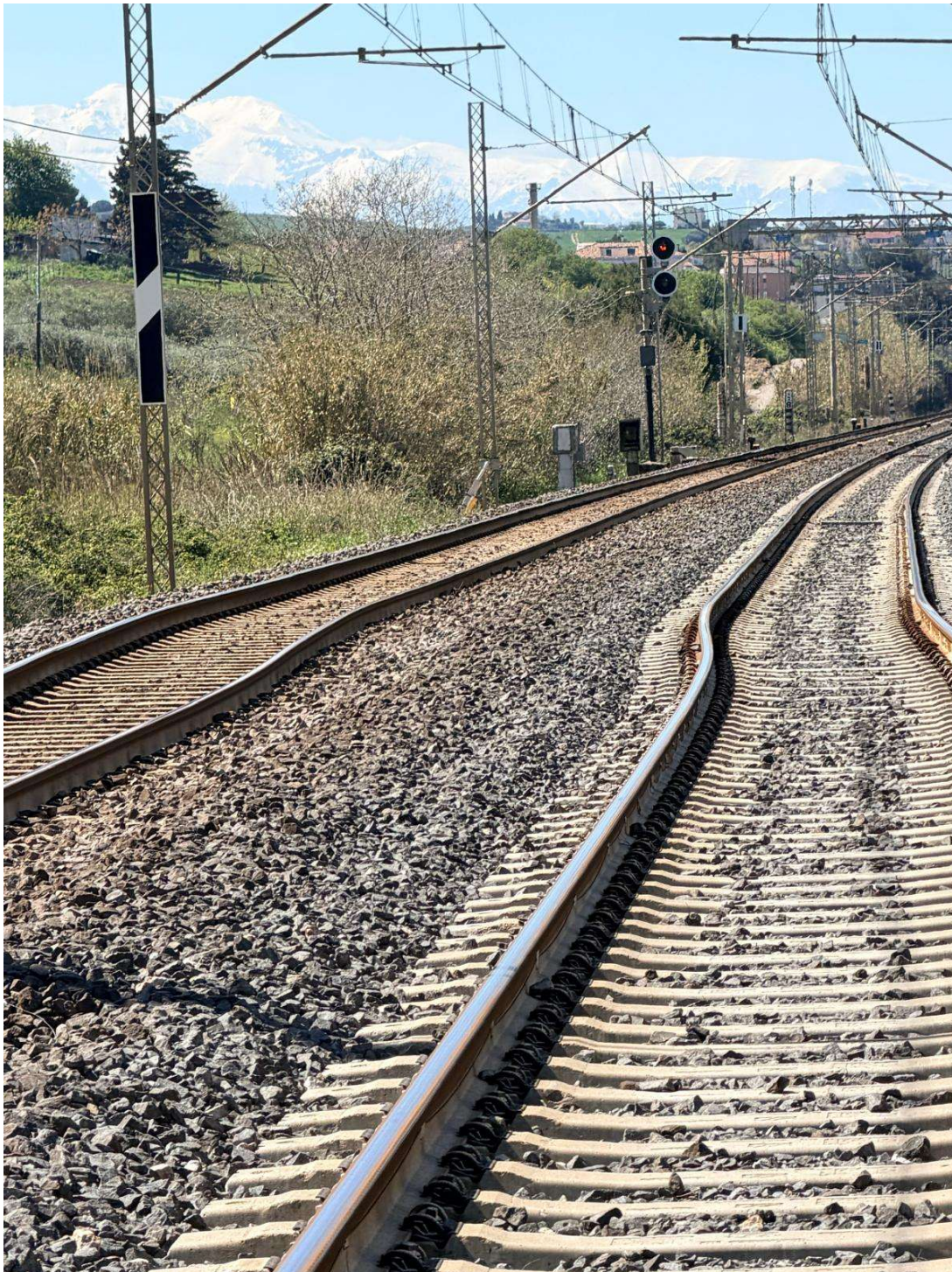
Figura 16 - Frana di Petacciato - Ferrovia Adriatica con disassamento binari.
